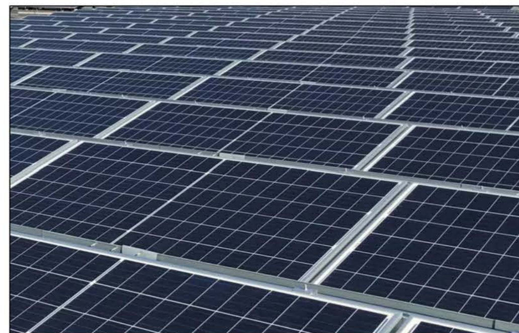
Rooftop solar PV array
