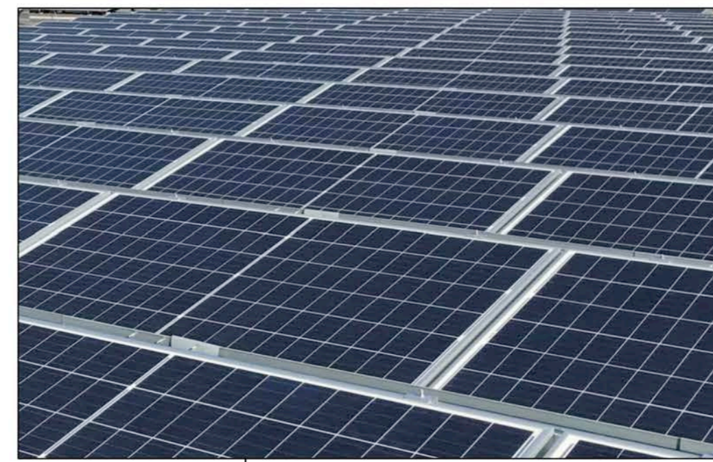
Rooftop solar PV array
