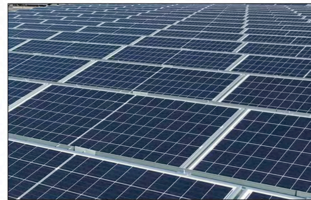
Rooftop solar PV array
