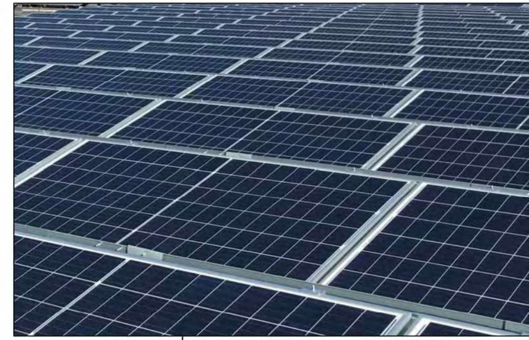
Rooftop solar PV array
