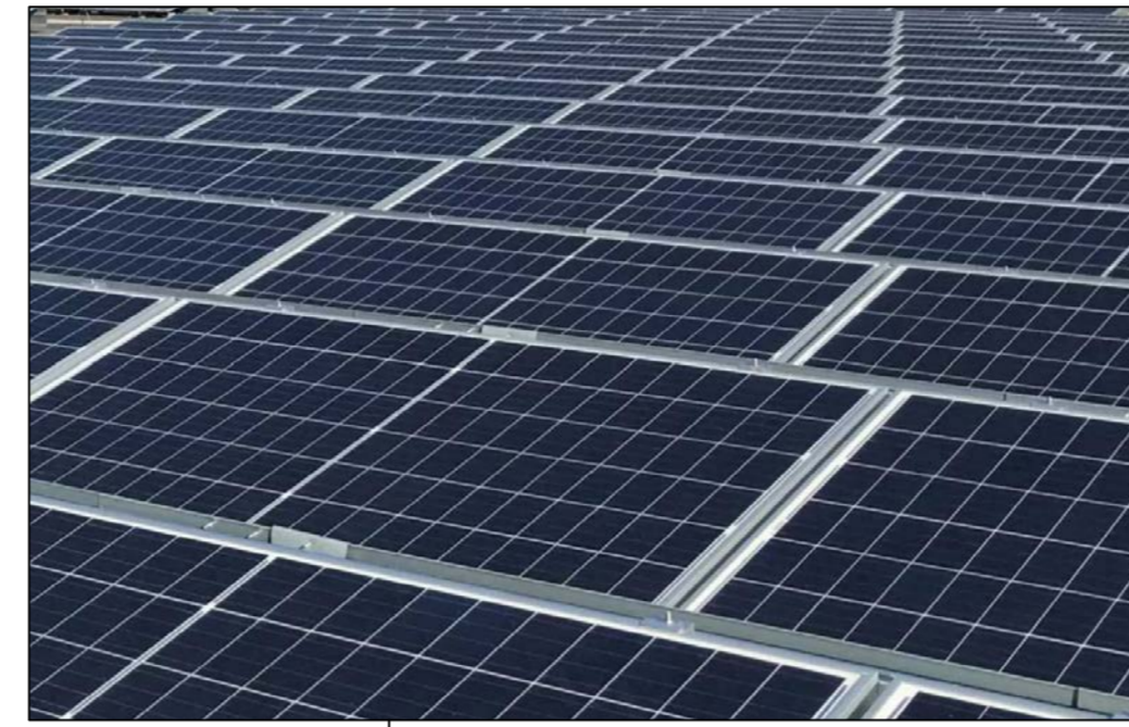
Rooftop solar PV array
