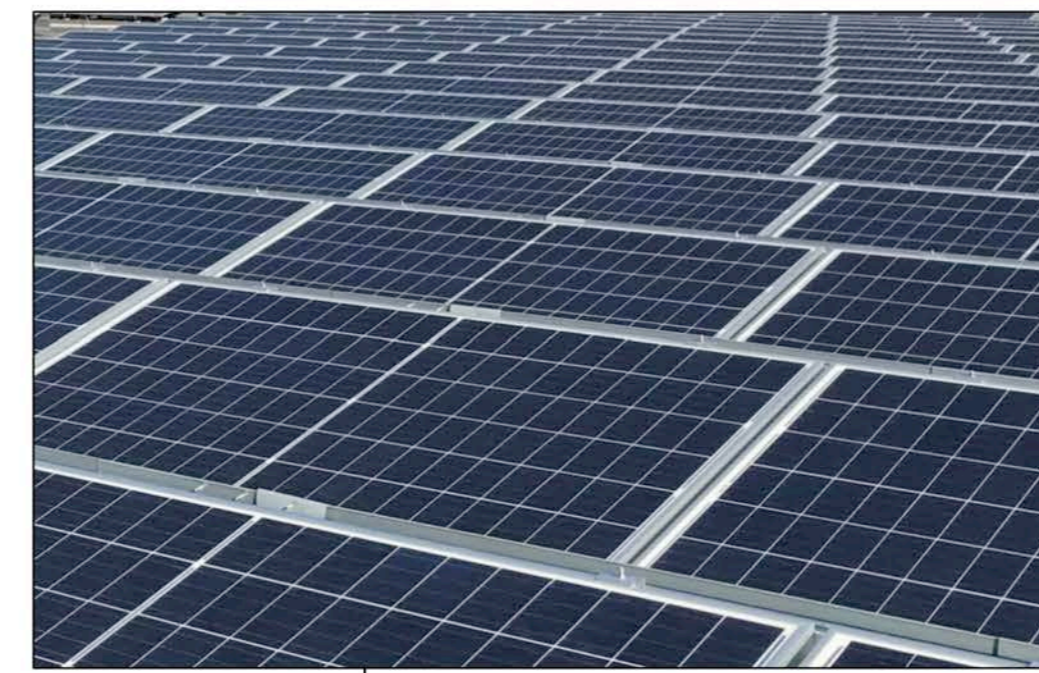
Rooftop solar PV array
