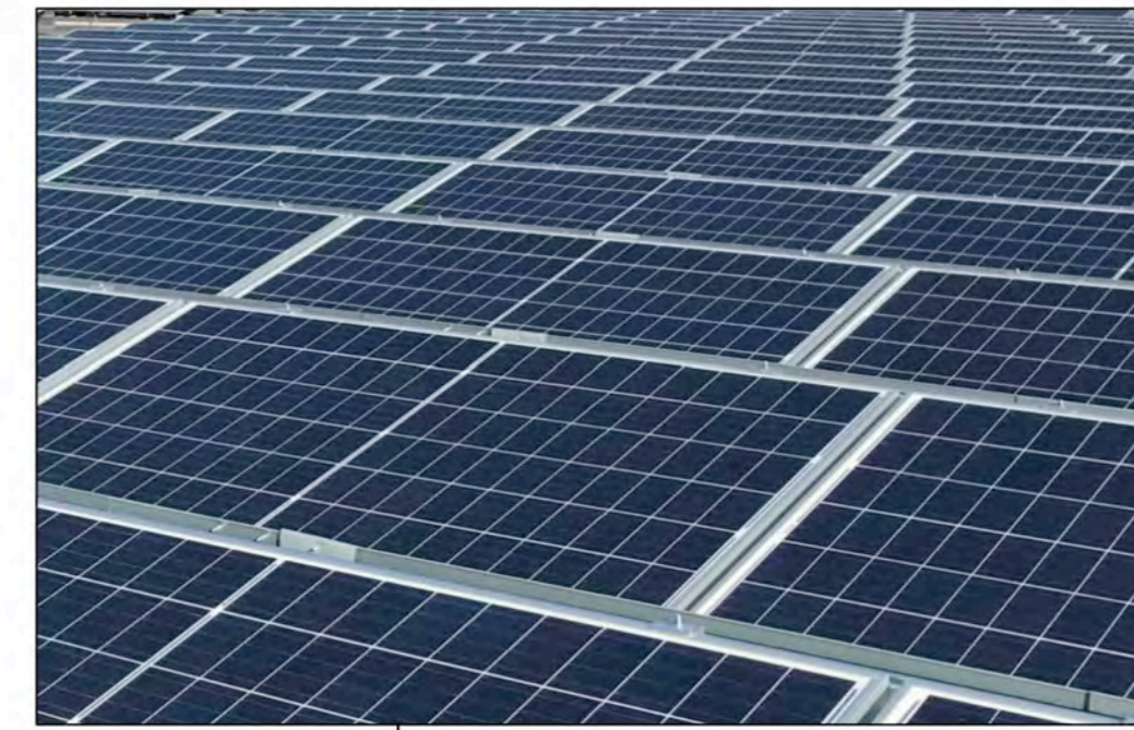
Rooftop solar PV array
