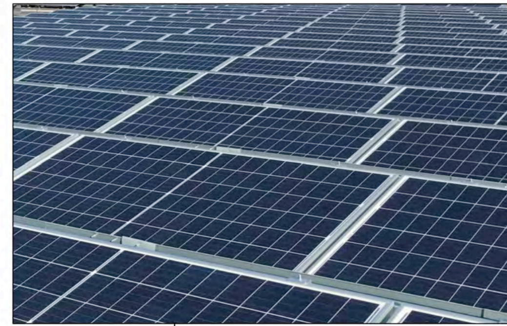
Rooftop solar PV array
